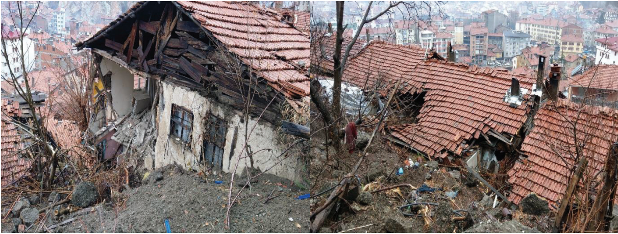
Şekil 2.16. Hacıpiri Mahallesiinde kaya düşmesi afetinden etkilenen konutlar
